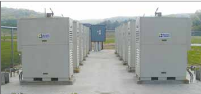
24 микротурбины Capstone, работающие на метане, производят электроэнергию на свалке округа Соук, штат Висконсин.
